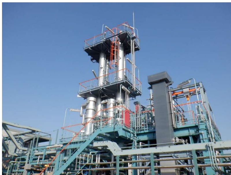
完成したケミカルリサイクルプラント
